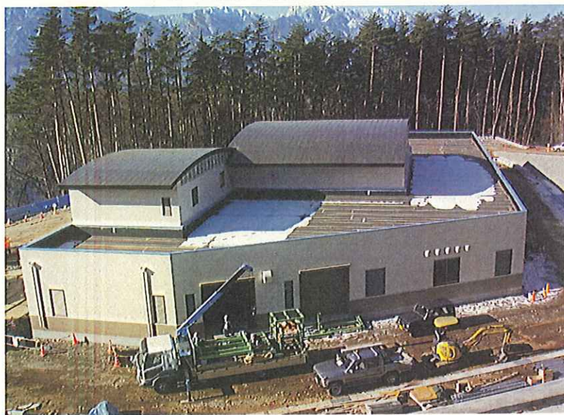
③ 浸出水処理施設
