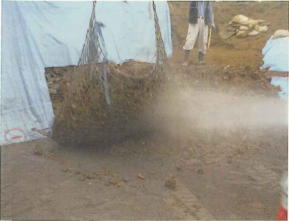
同日(10/24) 廃棄物の積み下ろし状況 この際も散水し、アスベスト粉じんの飛散を防止
