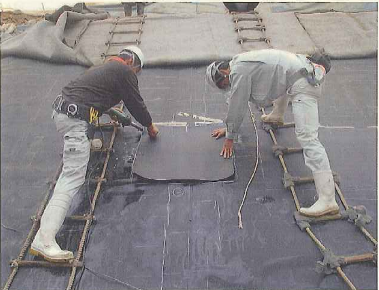
同日(10/19) 下層不織布に損傷等異常なしを確認したため、修復用遮水シートの熱溶着を開始
